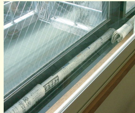
③カーテンを二重にすると窓の結露水が増えます。それを吸収するために新聞紙を丸めておいた事例
