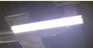
▲店舗バックヤードLED照明
