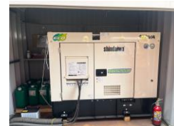
非常用発電機
