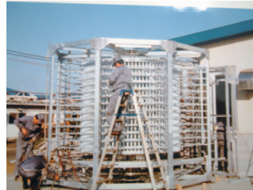
スパイラルコンベア
