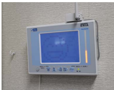
デマンド監視装置
