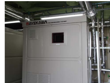
水熱源ヒートポンプ
