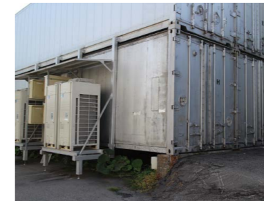
冷凍コンテナ・冷凍機
