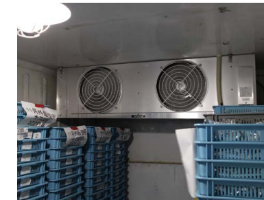
冷凍機(冷凍庫内部)
