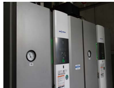
蒸気ボイラー
