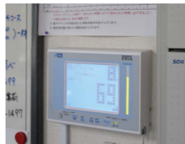
デマンド監視装置
