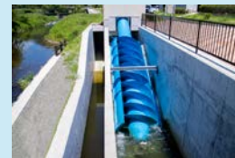
低落差でも安定して発電可能な水車の開発事例
