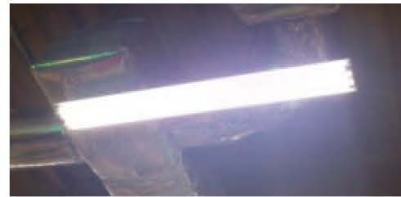
▲店舗バックヤードLED照明
