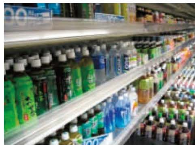
▲省エネルギー制御する冷ケース
