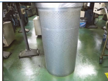
▲置換換気システムの給気口
