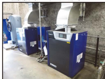
▲廃熱利用しているコンプレッサー
