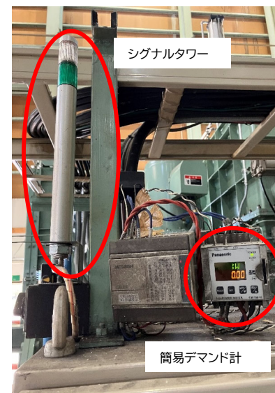
▲炉に設置されたシグナルタワー
