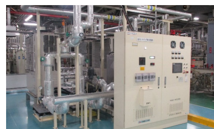
▲洗浄液加温にヒートポンプを導入
