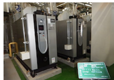
▲ボイラー燃料を重油から天然ガスに転換
