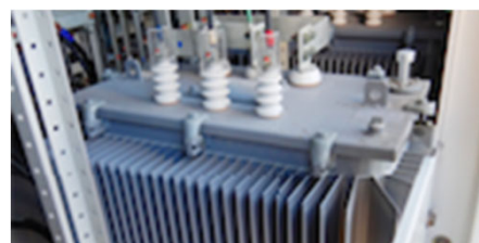
▲2023年に設置された高効率変圧器
