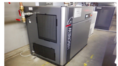
▲最新インバーター制御 エアークンプレッサーに更新
