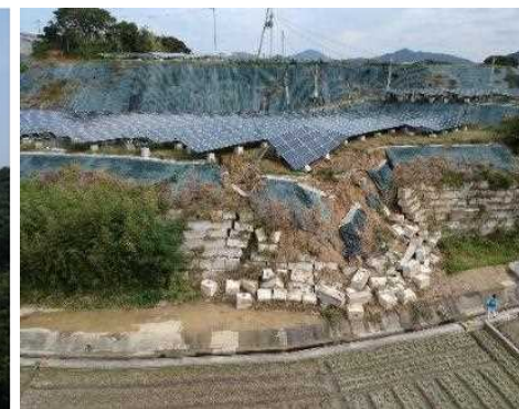
法面保護工が崩れて流出した事例
