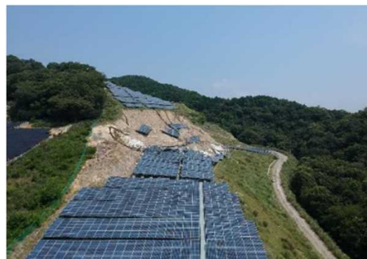
傾斜地の崩壊が発生したため、 法肩部分の架台が流出した事例
