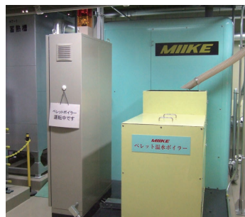
ペレットボイラー
