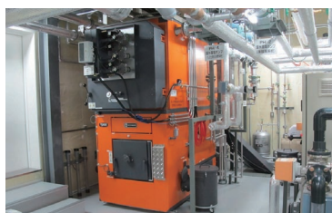
チップボイラー
