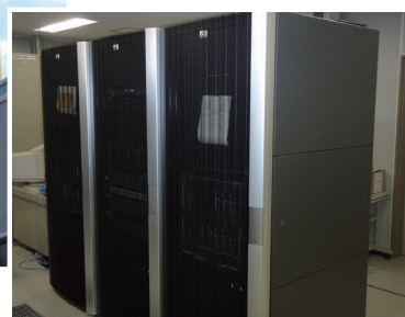
高効率サーバー設備
