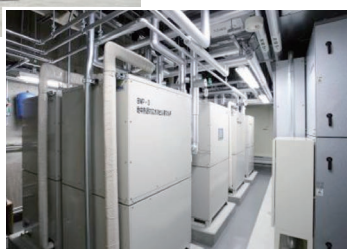
地中熱ヒートポンプ
