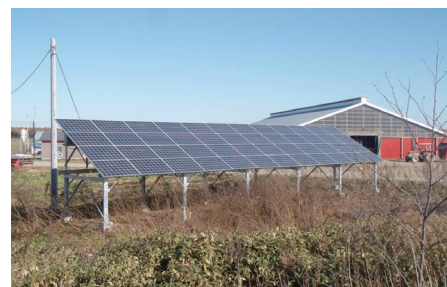
太陽光発電設備
