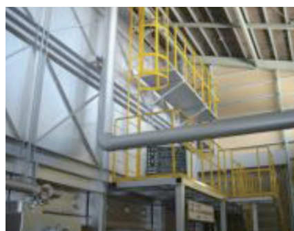
バイオマスボイラー
