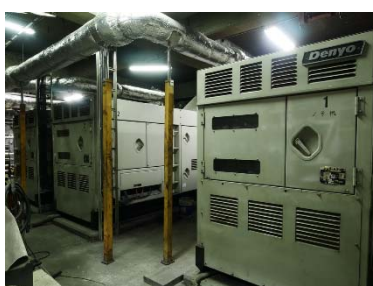
防音型エンジン発電機（4 機）
