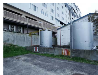
屋外貯蔵タンク（2 基）
