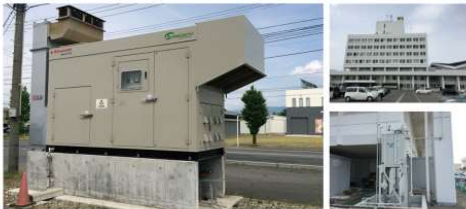
山形県 米沢市役所様 灯油式ガスタービン非常用発電機 (375KVA 屋外設置)
