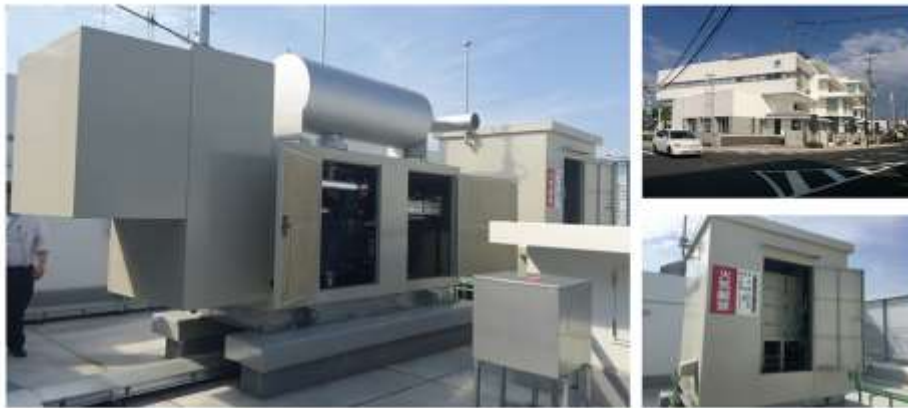
福島県 田村市役所様 A重油式非常用発電機 (250KVA 屋上設置)
