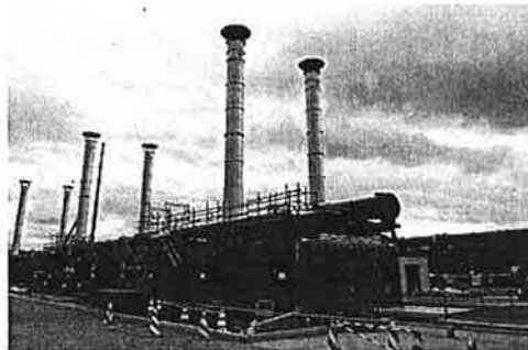
【緊急設置電源（南早来発電所）】
