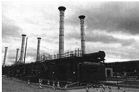
【緊急設置電源（南早来発電所）】
