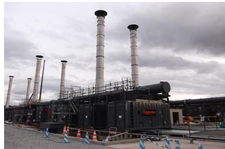
【緊急設置電源（南早来発電所）】
