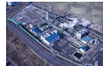
CO2分離・回収・貯留施設
