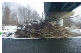
平成28年8月出水後の流木状況
