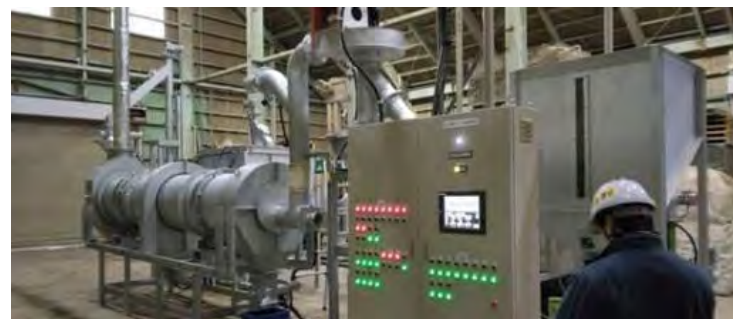
バイオコークス製造プラント2期工事分（破砕機＋乾燥装置）
