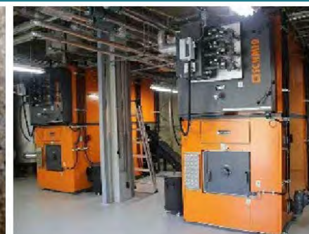
木質バイオマスボイラー
