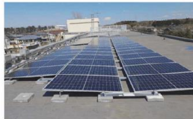
太陽光パネル
