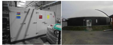
バイオガス発電機
