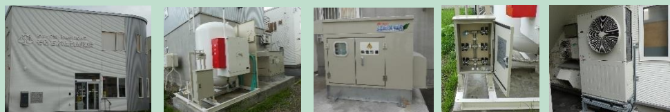
災害用LPガスバルク貯槽と非常用LPガス発電機
