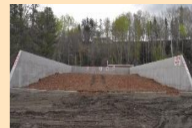
雪氷冷熱利用設備の一部 (貯雪設備)
