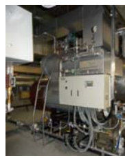
天然ガスボイラ
