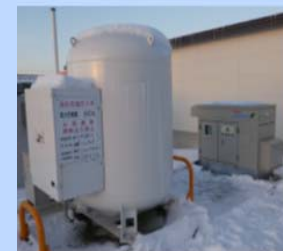
LPガス災害バルク貯槽、発電機
