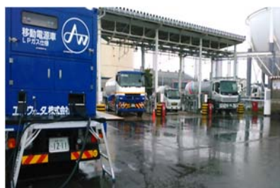
大型移動電源車による給電・充填作業 (函館LPG基地)
