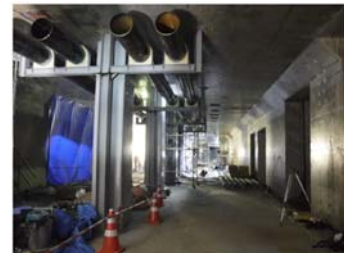
地下通路に敷設した熱導管ネットワーク
