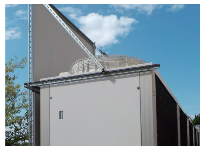
室外機の遮熱板
