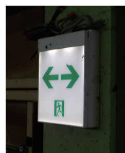
非常誘導灯のLED化
