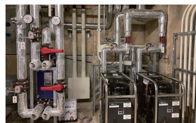
温泉排湯から廃熱を熱回収するヒートポンプ(右)と、融雪用プレート式熱交換器(左)。冬季のロードヒーティングにも温泉の廃熱を活用している。
